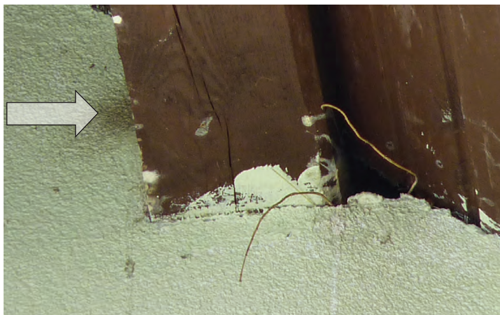
Fot. 35. Na tym zdjęciu widać dwie oznaki wskazujące, że ptaki mogą odbywać tu lęgi. Po prawej stronie wystaje materiał gniazdowy, po lewej widać pociemnienie pozostawione przez regularnie wchodzącego i wychodzącego w tym miejscu ptaka (DZ)
