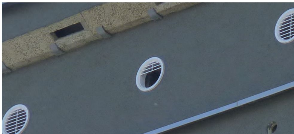
Fot. 102. Zmodyfikowana kratka blokująca dostęp do stropodachu gołębom miejskim (DZ)
