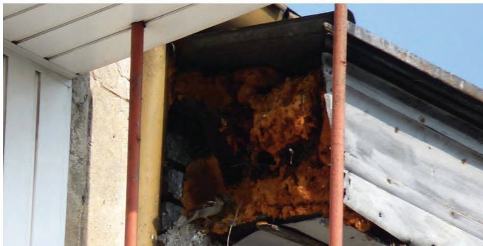
Fot. 51. Uszkodzona boczna część gzymsu umożliwiła gniazdowanie w jego wnętrzu wróblom oraz jerzykom (DZ)
