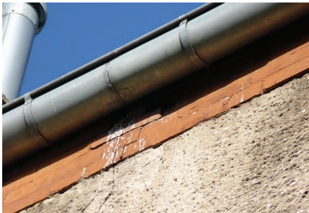
Fot. 60. Pobielenie kałem na elewacji. W tym miejscu regularnie przesiadywały wróble, ale nie odbywały lęgów (DZ)
