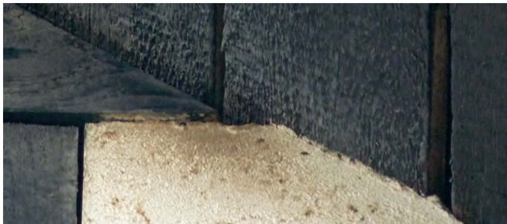
Fot. 71. Pod szczeliną stanowiącą wlot do kolonii dobrze widoczne wytłuszczenie pozostawione przez futro przemieszczających się tędy nietoperzy (DZ)
