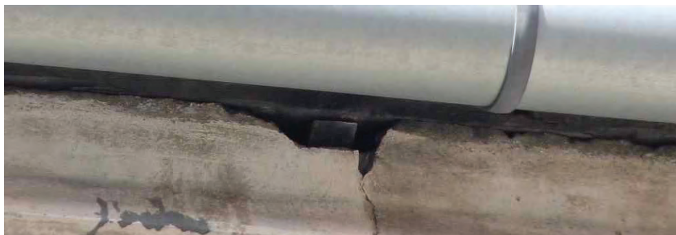
Fot. 50. Ta niewielka szczelina prowadziła do gniazda jerzyków. Pomimo jasnego odcienia elewacji ślady pod szczeliną nie powstały (DZ)
