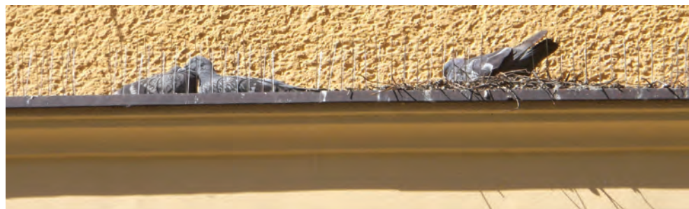
Fot. 127. Gołębie miejskie gniazdujące pomiędzy kolcami zamontowanymi na budynku Starostwa Powiatowego w Białogardzie, woj. zachodniopomorskie (DZ)
