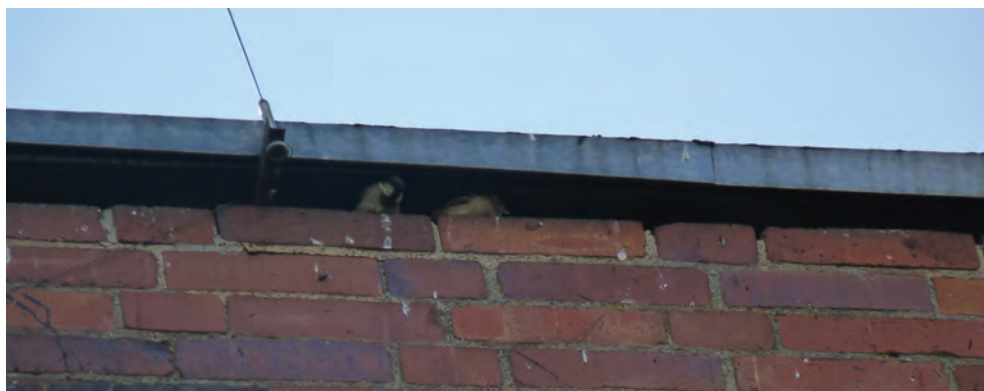
Fot. 52. Pod obróbką blacharską dachu płaskiego, pomimo pozornie wysokich temperatur tam panujących, miejsce na gniazdo wybrały wróble. Podobne miejsca mogą być zajmowane przez kolonie rozrodcze nietoperzy (DZ)
