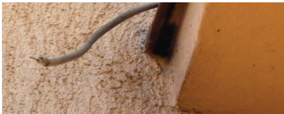
Fot. 79. Ciemna plama na styku balkonu i elewacji to szczelina nie większa niż 2cm, która jedynie z niedokładności robotników wykonujących termomodernizację nie została zasłonięta, umożliwiając nietoperzom nadal korzystać z tego miejsca (DZ)
