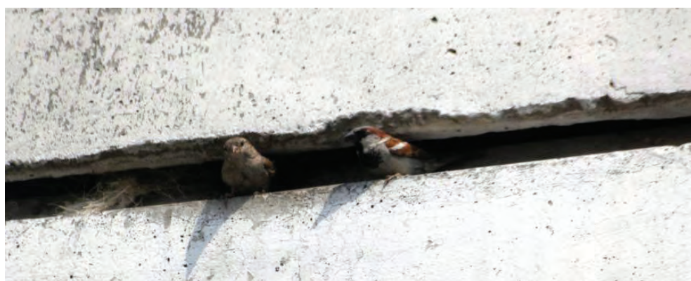
Fot. 38. Wróble gniazdujące w szczelinie dylatacyjnej (AT)
