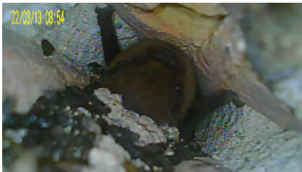
Fot. 93. Ten ukryty w głębokiej szczelinie karlik zostałby zamurowany w swojej kryjówce, gdyby nie dokładne przeszukanie elewacji za pomocą endoskopu (DZ)
