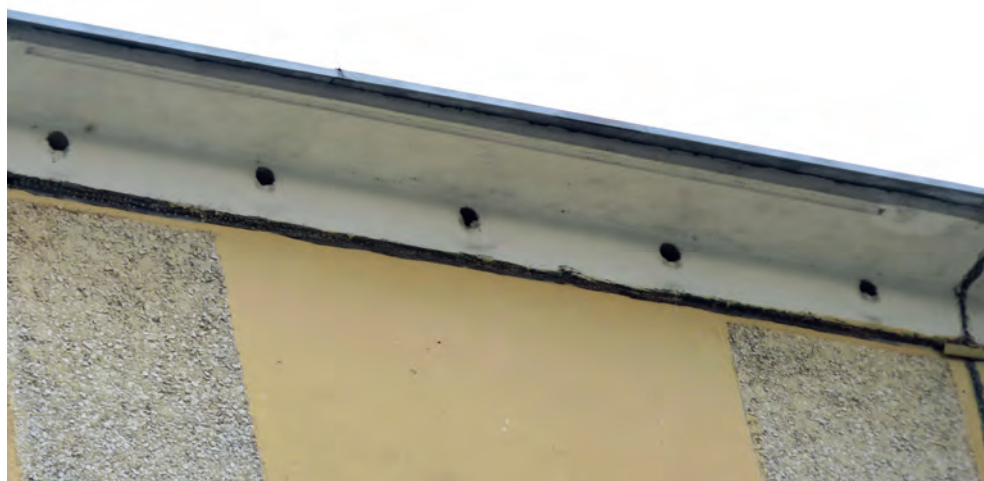
Fot. 30. Otwory wentylacyjne stropodachu, w którym stwierdzono gniazdowanie jerzyków (DZ)
