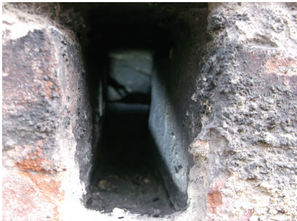
Fot. 95. Ta szczelina prowadzi daleko w głąb elewacji, poza zasięg metrowej długości kamery endoskopu. Może to być potencjalne zimowisko nietoperzy (DZ)
