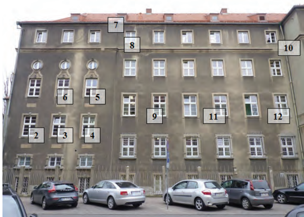
Fot. 132. Ponieważ przestrzeń pod parapetami są miejscem chętnie zajmowanym przez ptaki i nietoperze, na tym budynku dla każdej z nich została wykonana i zaprezentowana dokumentacja zdjęciowa (DZ)
