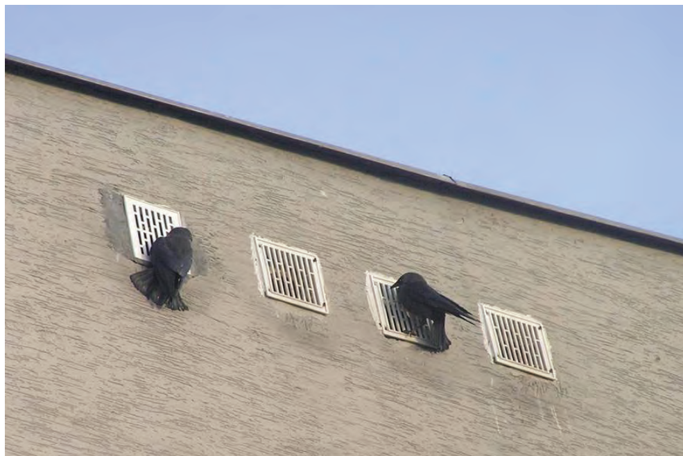
Fot. 11. Kawki próbujące się dostać do miejsc gniazdowania w stropodachu, który zakratowano. Pracując wytrwale potrafią wyrwać kratki po jakimś czasie (ML)
