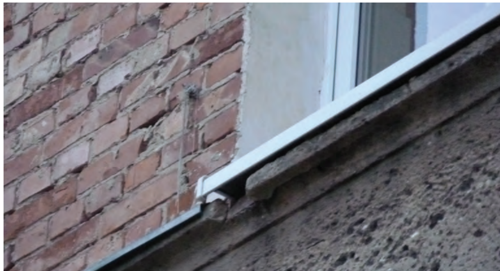
Fot. 44. Szczelina pod parapetem prowadząca do gniazda jerzyków. Ze względu na strukturę elewacji i czysty tryb życia tych ptaków pod spodem nie ma żadnych śladów (DZ)
