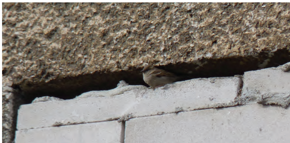
Fot. 2. Samica wróbla przy gnieździe ukrytym w zamurowanym otworze okiennym (DZ)
