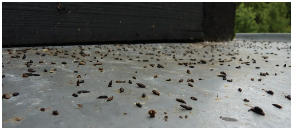
Fot. 72. Pod wejściem do kolonii liczącej setki osobników na ziemi oraz na elewacji gromadzi się sporo odchodów (DZ)
