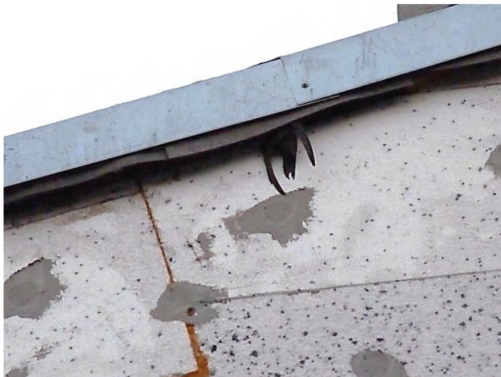
Fot. 22. Ten jerzyk próbuje bezskutecznie dostać się do gniazda, które zajmował rok wcześniej. W wyniku sporządzenia opinii jesienią prace termomodernizacyjne budynku zostały przeprowadzone bez uwzględnienia ochrony miejsc gniazdowania ptaków bądź kompensacji za ich zniszczenie (DZ)
