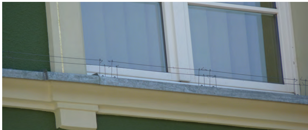
Fot. 129. Elewację Urzędu Miejskiego w Szczecinie zabezpieczono przed gołębiami miejskimi za pomocą niemal niewidocznych, ale skutecznych prętów obrotowych (DZ)
