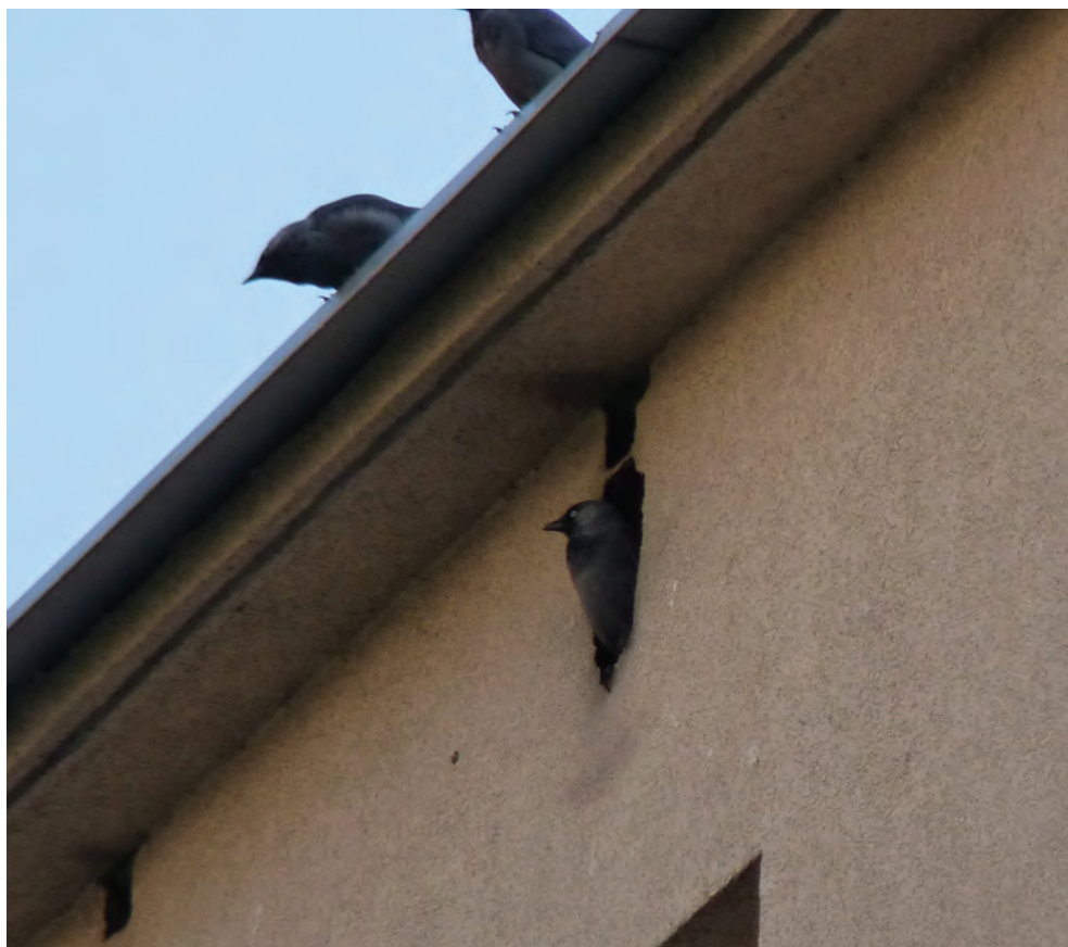
Fot. 70. Kawki gniazdujące w stropodachu (DZ)
