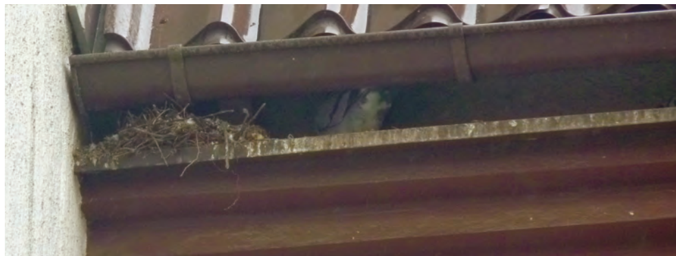
Fot. 90. Gołębie miejskie gniazdujące na gzymsie pod rynną (DZ)
