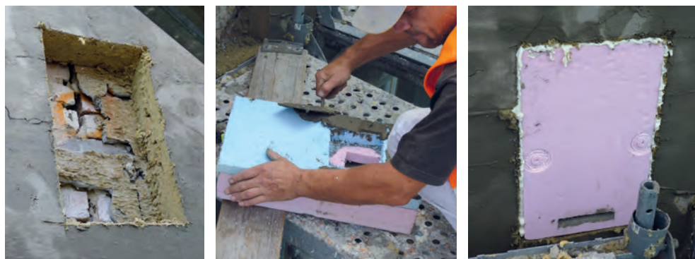
Fot. 104. Szczelina pomiędzy cegłami w ścianie tej kamienicy prowadziła do wykorzystywanego co roku zimowiska nietoperzy (DZ)
