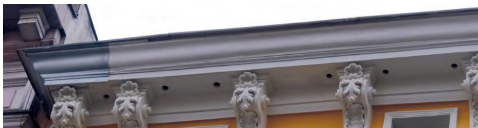
Fot. 101. W gzymsie tej kamienicy gniazdowały jerzyki dostając się do wnętrza przez szczeliny w spodniej części. Po remoncie w miejscach pierwotnych wejść do gniazd wywiercono otwory o średnicy 5 cm (DZ)
